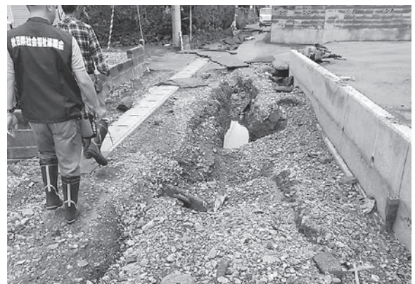
崩壊した道路（大館市）
